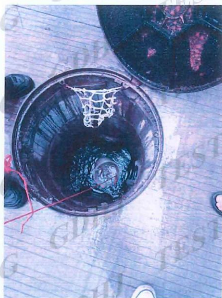
生活污水排放口
